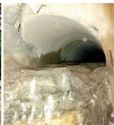
Canalisation obstruée par la calcite
